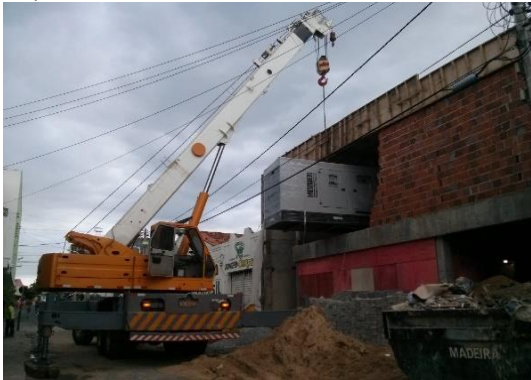
Colocação do Grupo Gerador 220 KVA da Unidade.
