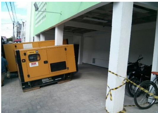
Sistema de Geradores (Alugados) para abastecimento elétrico da Unidade.
