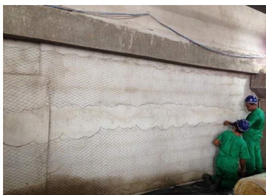
Aplicação de Tela de fixação do reboco com impermeabilizante nas paredes periféricas.
