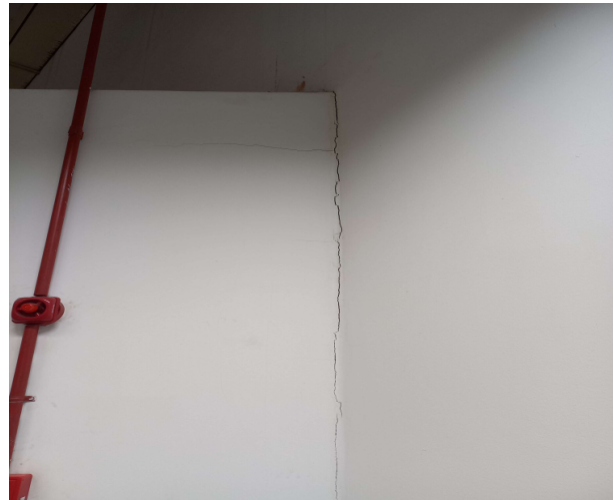
Figura 8: Parede com fissuras
