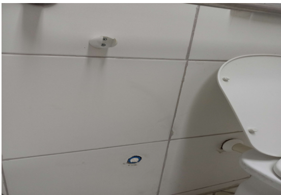
Figura 14: Falta de duchas nos banheiros
