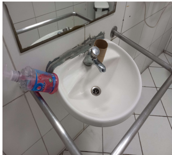
Figura 13: Pias mal fixadas
