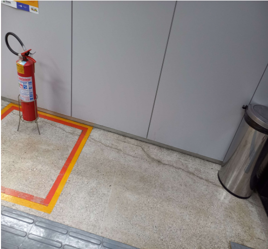
Figura 7: Piso com fissuras
