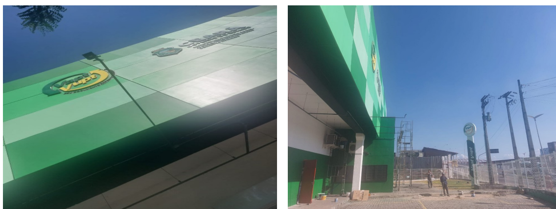
Figura 42: Verificação de NCE
